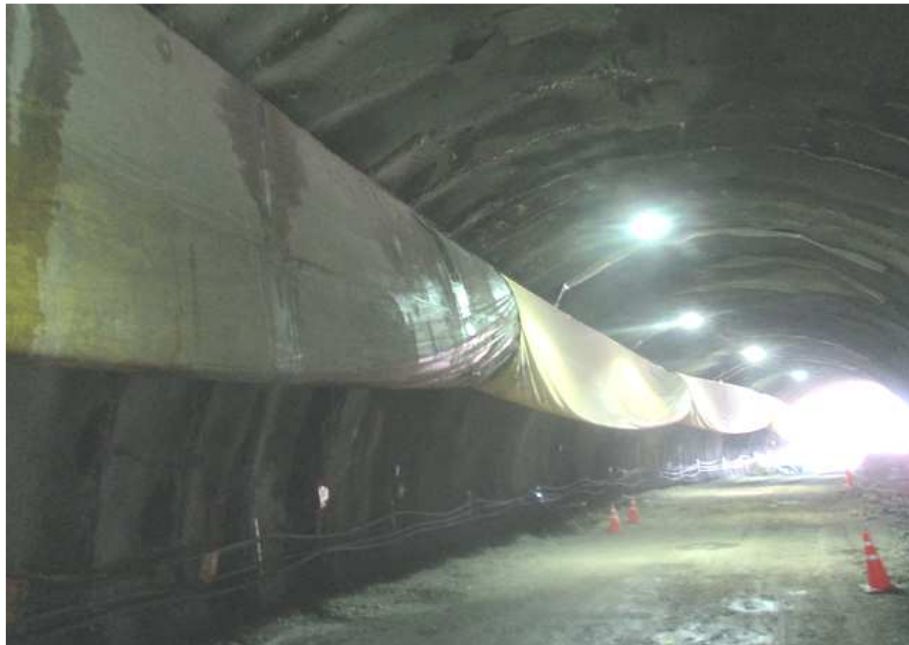
내부 환기시설 현황
