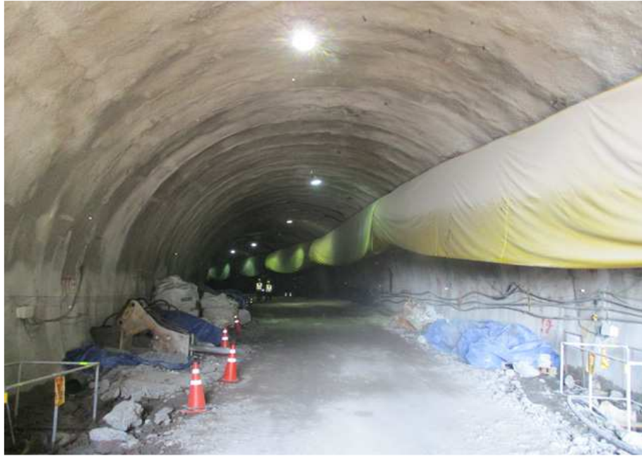
내부 환기시설 현황
